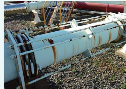
プラント/工場施設では…
